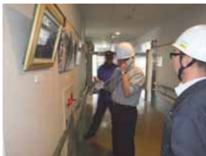
出火現場で火災状況の確認
